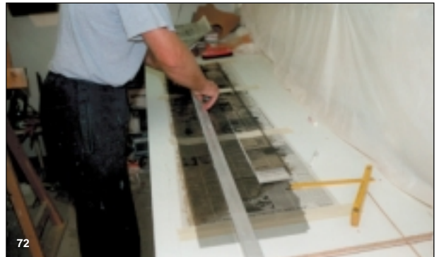
Bild 72 Von einem großen, vorgetränkten und mit Folie abgedeckten Gewebestück werden entsprechende Streifen abgeschnitten.
